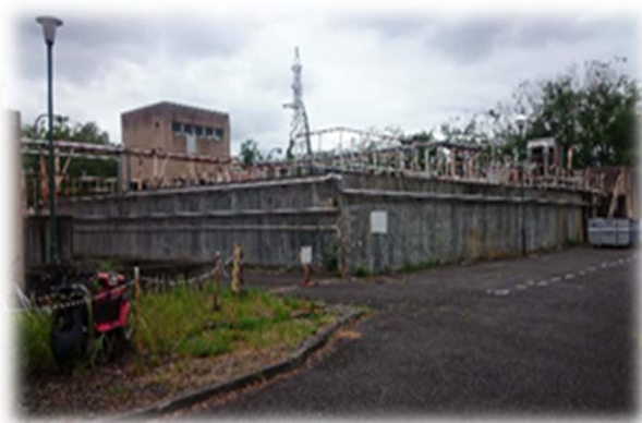
【廃水処理施設 外観】
