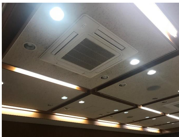
<更新された看護学科校舎空調>
