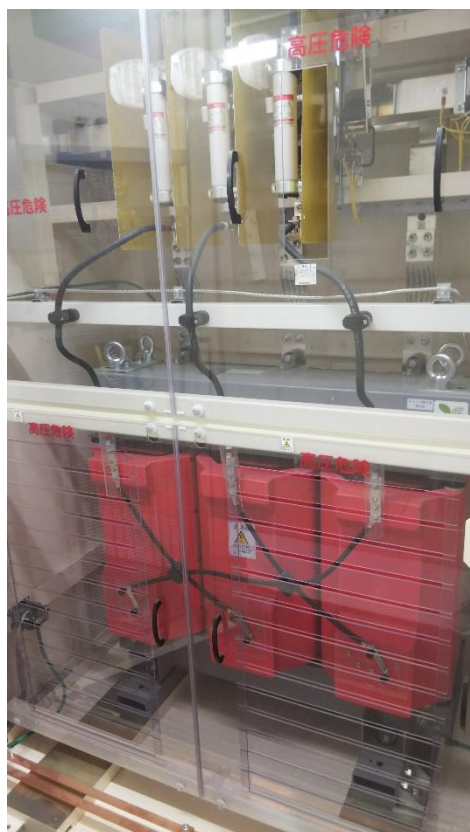
<更新された中央機械棟変圧器>
