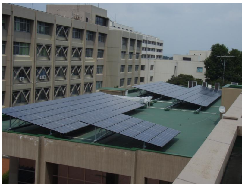
図. 8 - 1. 図書館屋上に設置された太陽光発電パネル
