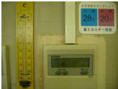
空調機の設定温度
