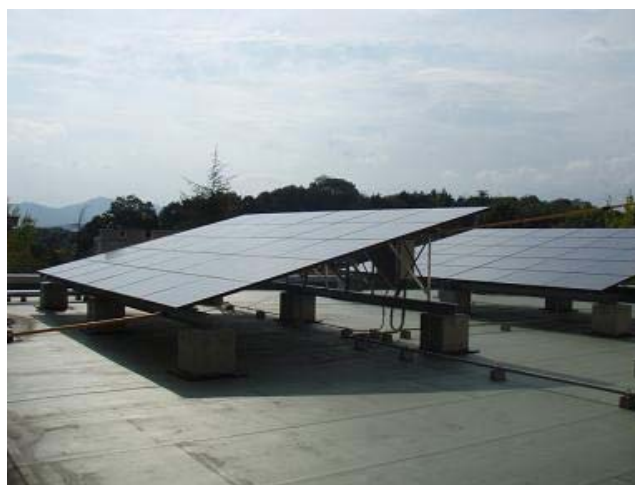
図. 5-7 基礎実習棟屋上に増設・設置された太陽光発電パネル
