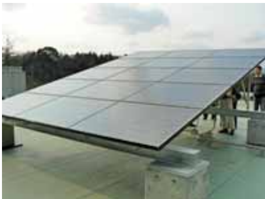
図. 5 - 7 屋上に設置された太陽光発電パネル
